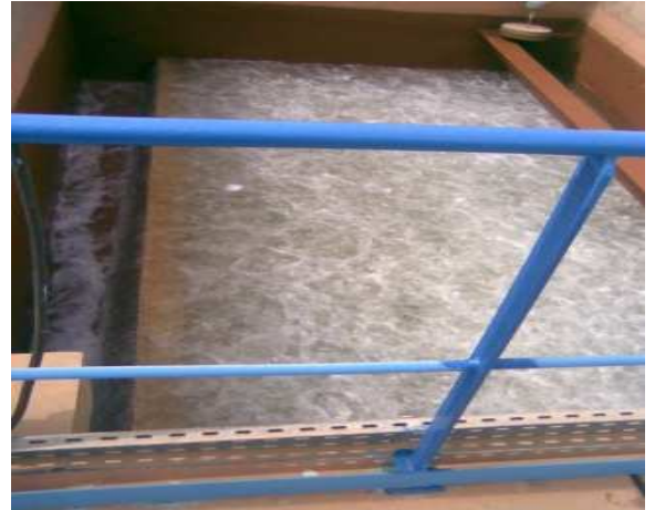
Figure 7 : filtres à sables
