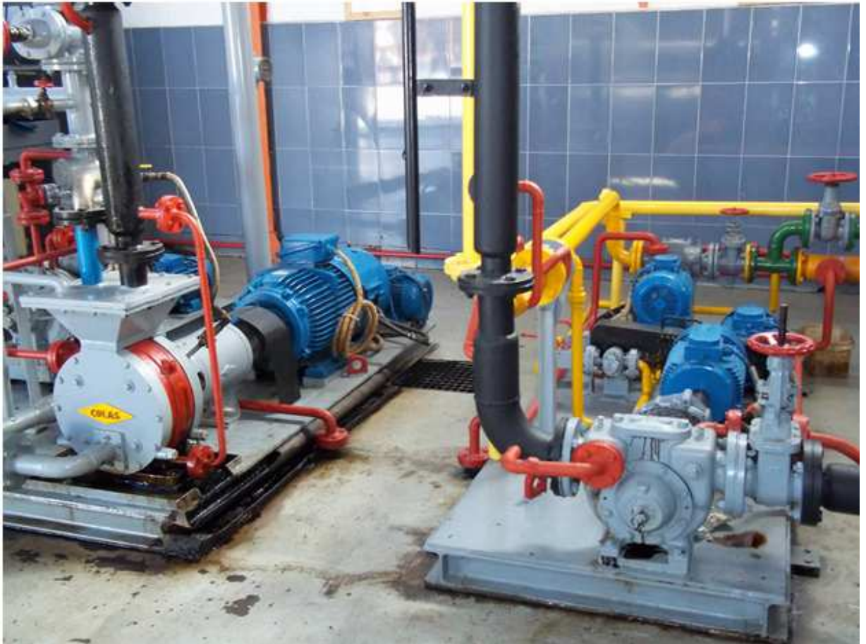
Figure 07 : Image réelle du groupe de fabrication d'émulsion
