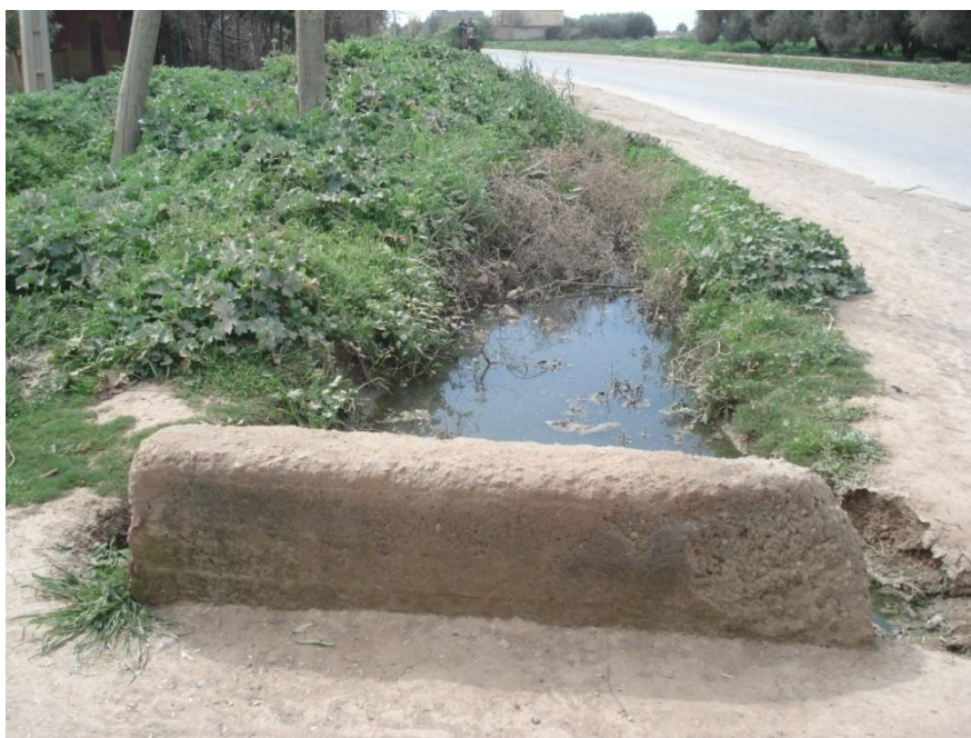
Figure 5 : photo montre la stagnation des eaux pluviales dans les points bas
