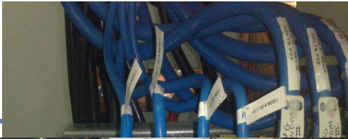
Photo 5: Les connections au niveau de l'armoire ou du PDB de Huawei (si appliqué)
