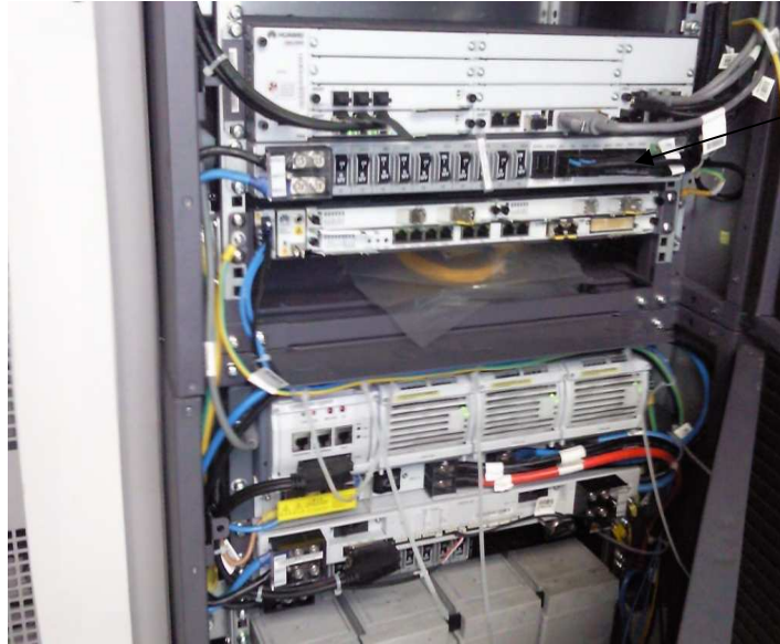
Figure 36: Installation du PTN910 sur un site d'accès
