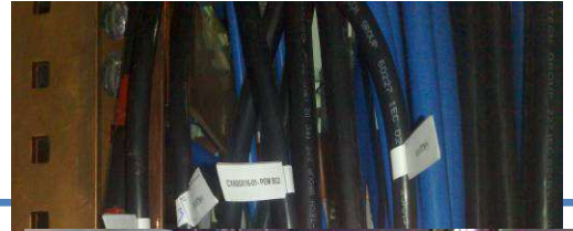
Photo 6: Acheminement du câble d'énergie sous les faux planché ou sur le chemin du câble
