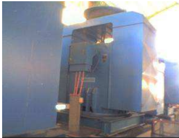
Figure 13 : Moteur asynchrone triphasé qui entraîne la pompe centrifuge
