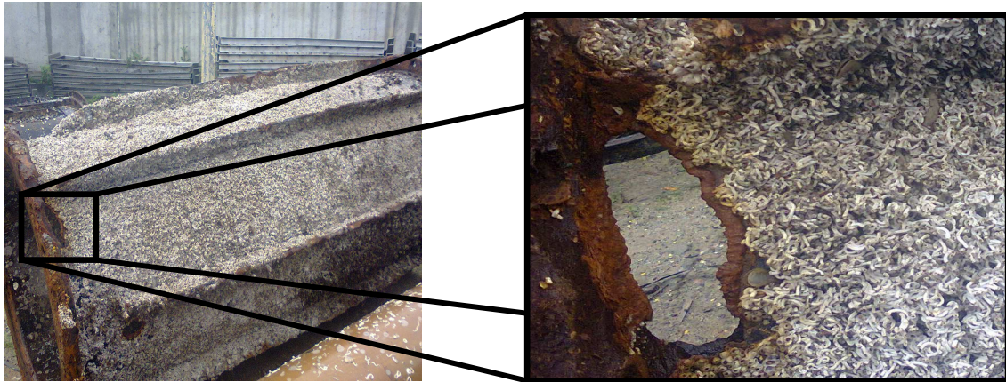
Figure 14 : Probleme de corrosion du materiel
