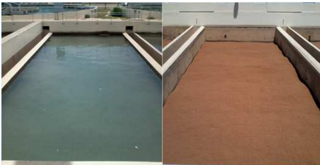
Photo7 : Filtres à sable
