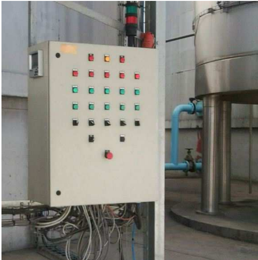
Figure 8 :l'armoire électrique de l'installation.
