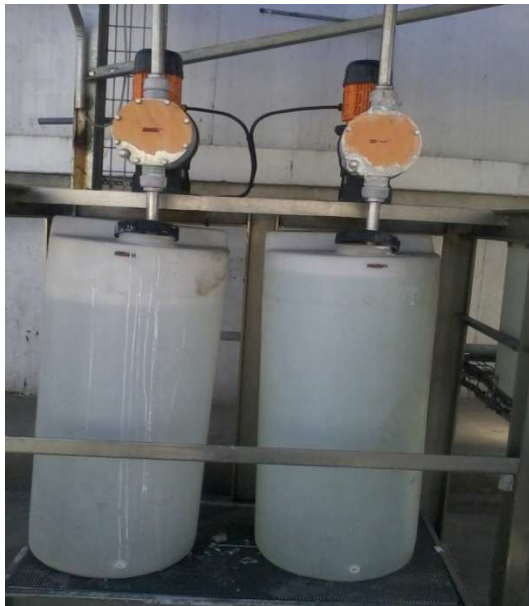
Figure 9 : les deux pompes doseuses montées sur les réservoirs de la soude et de l'acide.
