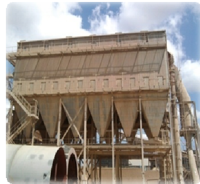
Figure 12 : cellule de dépoussiérage
