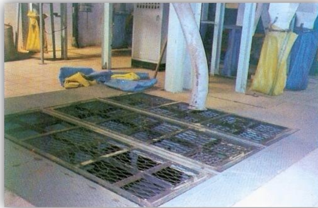
Photo 7: Une fosse munie d'une grille pour retenir les grosses impuretés
