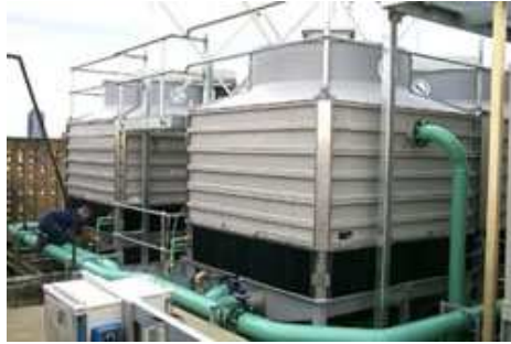
Figure 13 : Tour de refroidissement.
