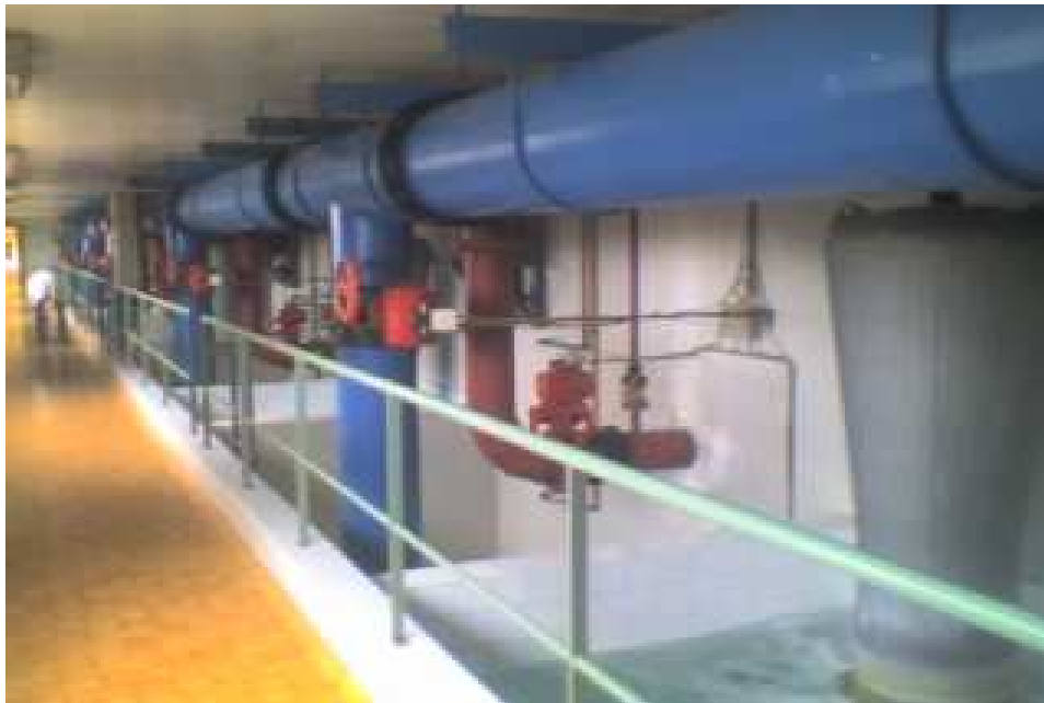
Photo6 : Opération de filtration dans la station de traitement.
